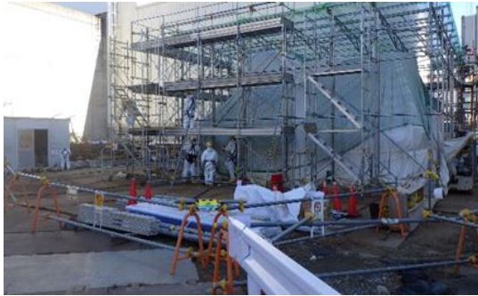
(写真1-1) サブドレン除鉄装置設置箇所外観 (南西側から撮影) 前回(令和2年12月22日)撮影
