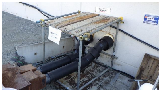
(写真2) 建屋滞留水移送配管の状況 (南西側から撮影)
