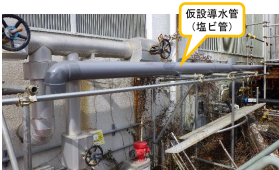
(写真 3) 仮設導水管の設置状況 (共用プール建屋東側を南東側から 撮影)
