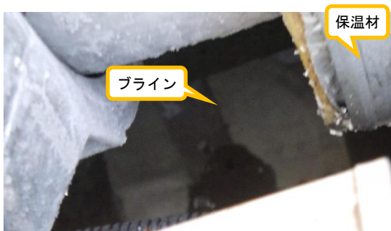
(写真 2-2) 漏えいしたブラインの一部が溜まった箇所 (配管の接続部の下側を接写)
