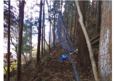
高エネルギー吸収型 落石防止柵工
