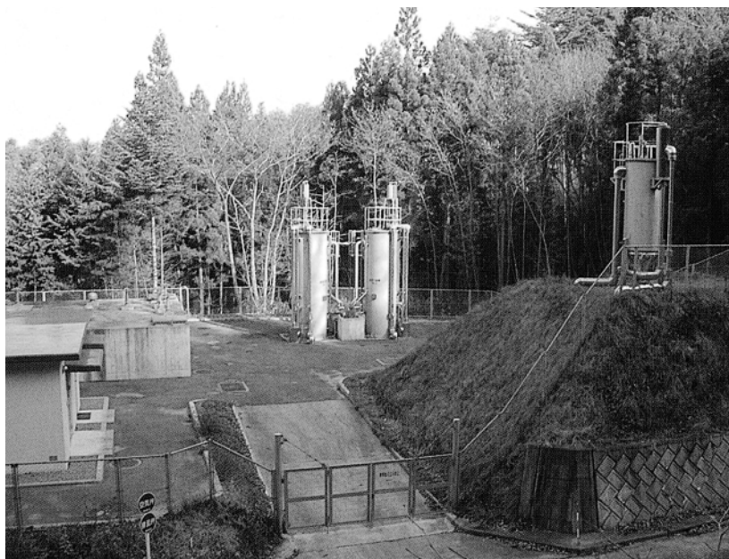
葛尾村落合簡易水道浄水場（平成13年7月 供用開始）
