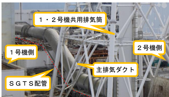
(写真1) SGT S配管の設置状況 (破線部がSGT S配管)
