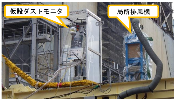
(写真 2 - 3) 吊り天秤上部に設置された仮設ダストモニタ及び局所排風機の状況
