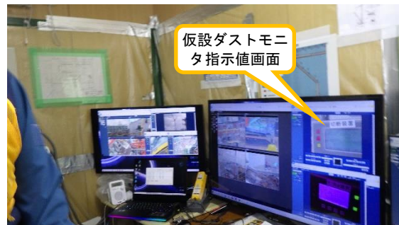
(写真 4 - 2) 遠隔操作画面の状況
