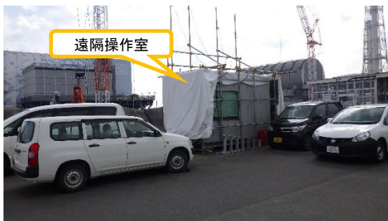
(写真 4 - 1) 遠隔操作室の状況
