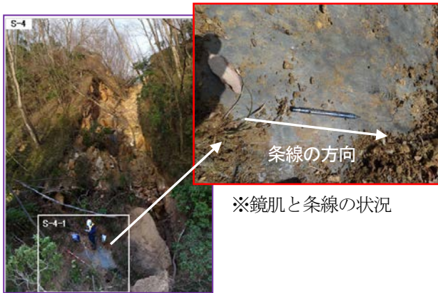
写真-2 頭部陥没帯の状況 (図-3 ①)
