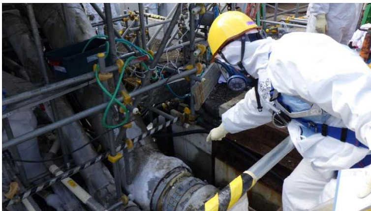
漏えい箇所を確認する駐在職員（手前）
