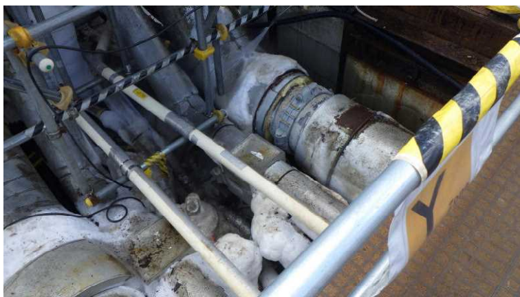
漏えい箇所の周辺の状況
