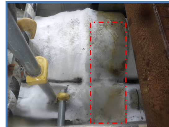
漏えい箇所 (真上より)
