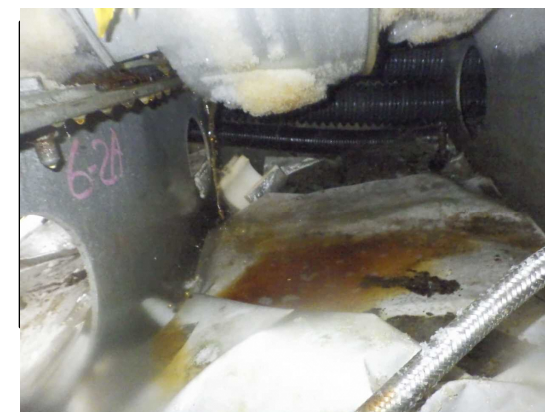
漏えい箇所 (直下)
