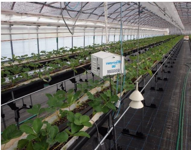
複合環境制御装置設置の様子
