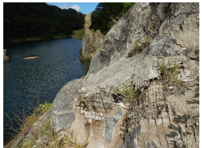
堤体周辺法面の劣化状況
