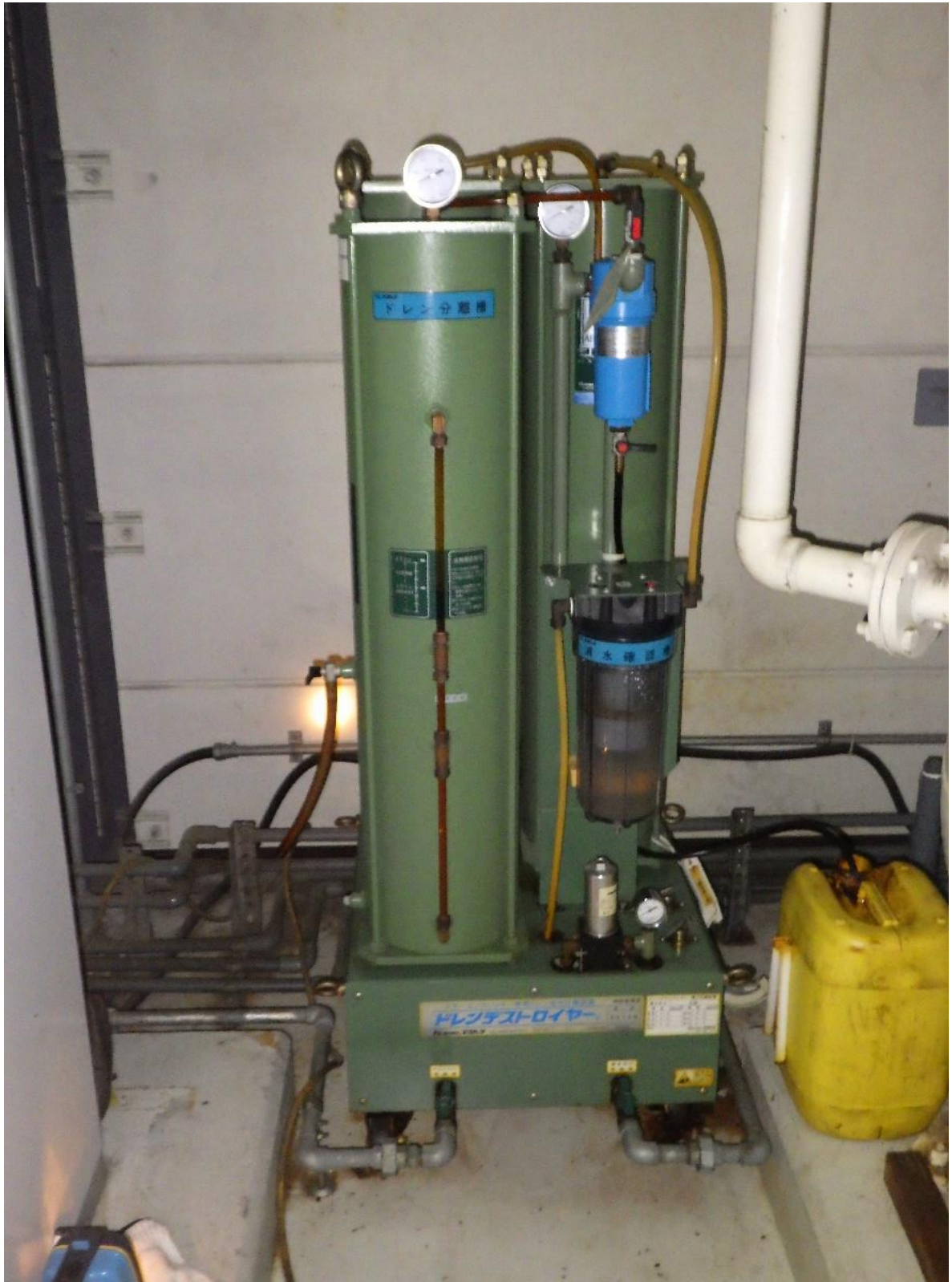
ドレン水処理装置（デストロイヤー）
