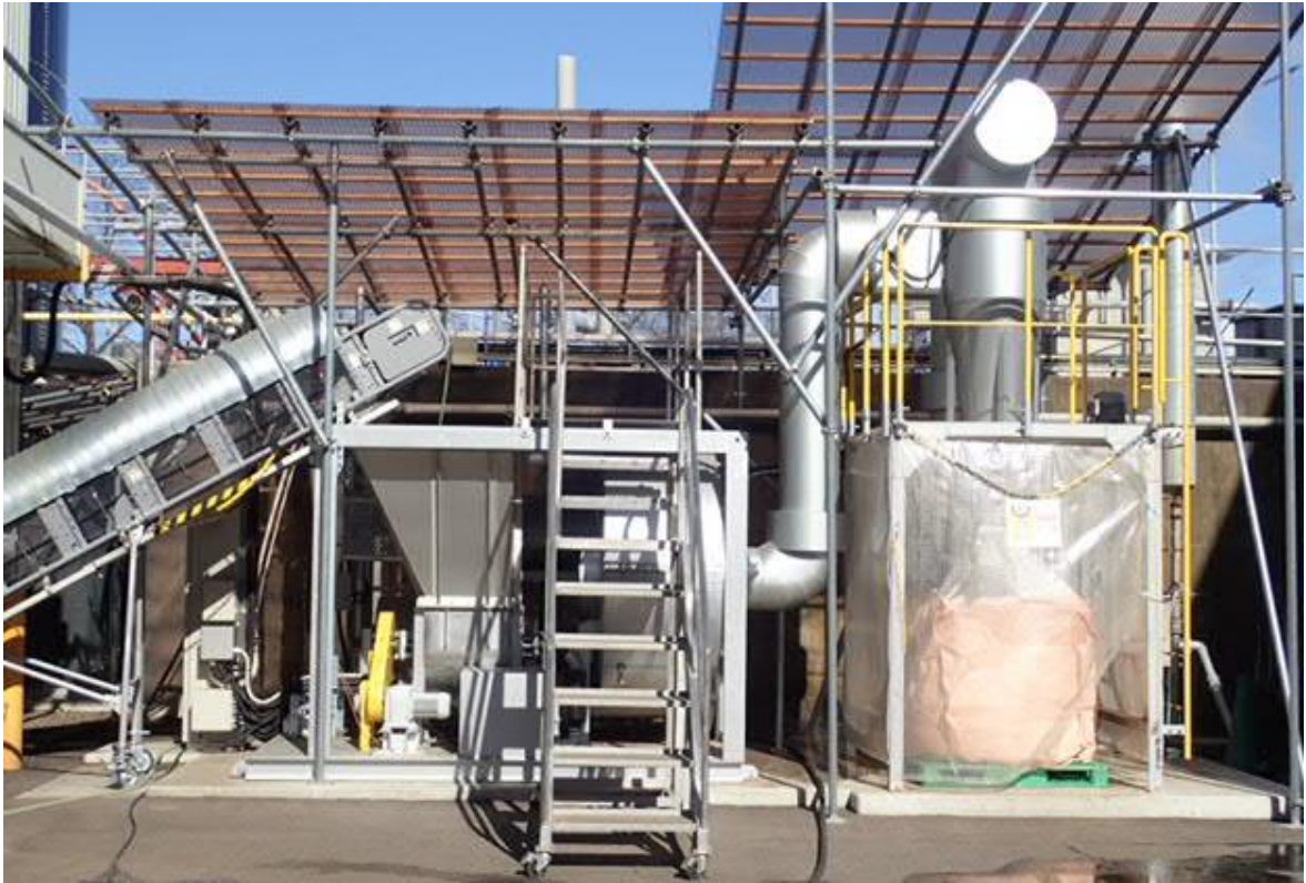
新設した乾燥機
