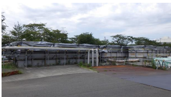
(写真3-1) 既設多核種除去設備周辺のノッチ タンク
