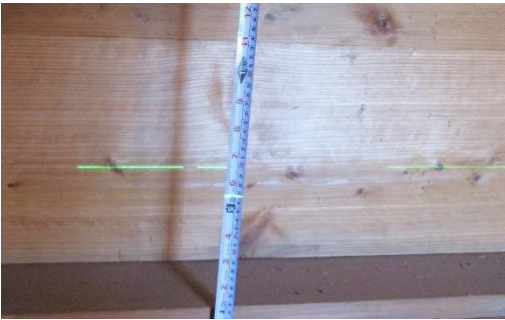
西壁中央付近の沈下幅測定 (-15mm)
