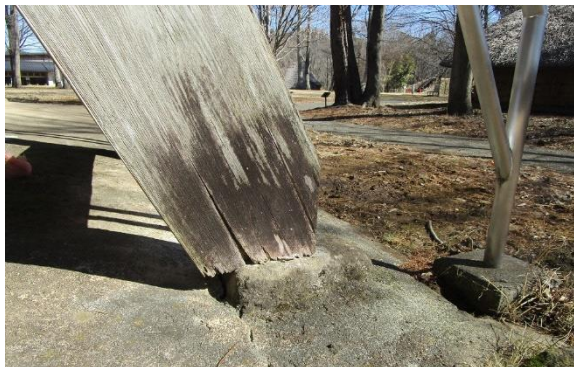
階段部分のズレの状況（南側から撮影）
