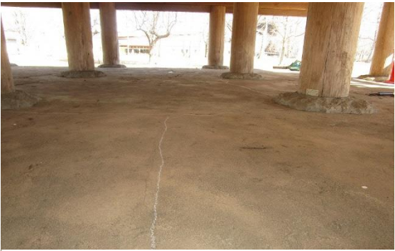
基礎のひび割れ状況
