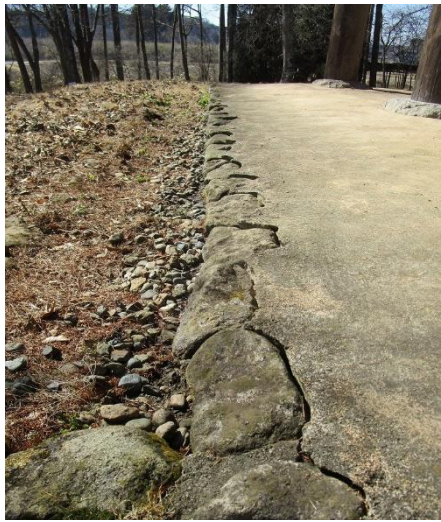
基礎縁石のひび割れ状況
