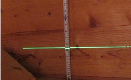
南西隅付近の沈下幅測定 (-10mm)
