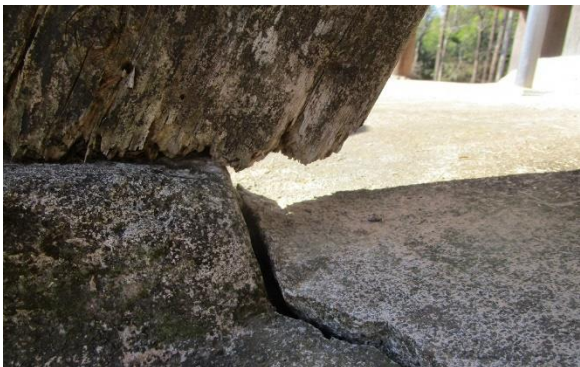
階段部分のズレの状況（北側から撮影）
