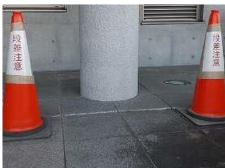
足洗場周辺の段差の現況
