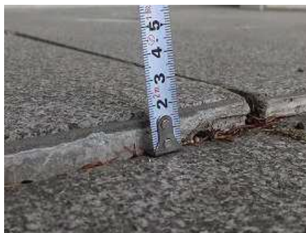
足洗場周辺の段差 (約15mm)
