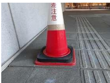
キャノピー側段差の現況
