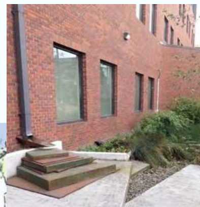
縦樋の非接続
