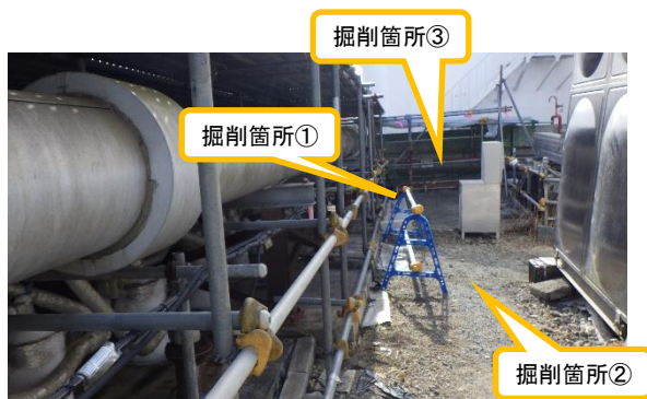
(写真1) 遮水壁外側(西側)掘削調査箇所の概観(北側から撮影)
