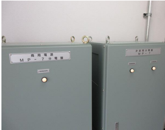
(写真2-1) モニタリングポストNo. 7の分電盤
