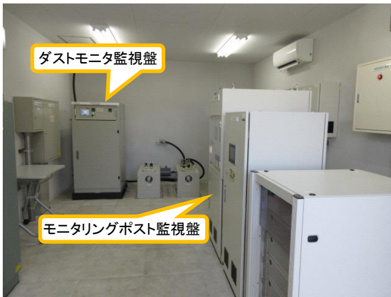
(写真1-3) 局舎内の状況
