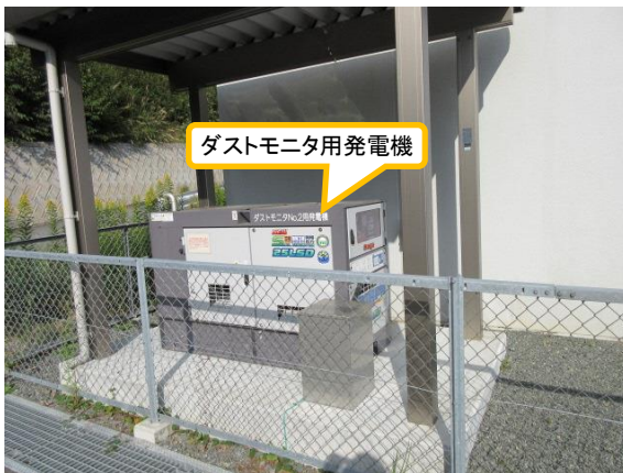
(写真2-3) ダストモニタ用発電機の状況
