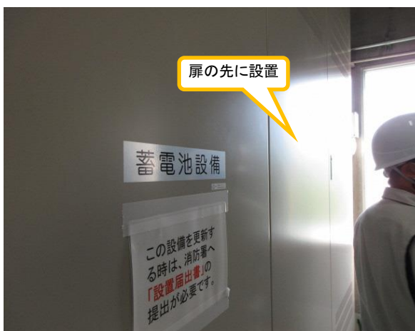
(写真4-2) CVCS (蓄電池) の状況
