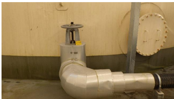
(写真2-1) N2タンク出口弁の状況 (散水が実施されていないため、「全閉」となっている。)
