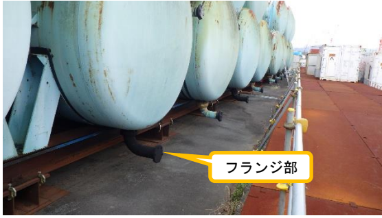
(写真3) タンク下部のフランジ部の状況
