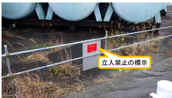
(写真2-2) 立入禁止の標示 (北東側)
