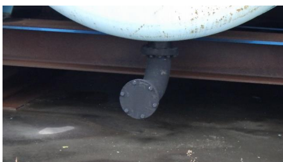
(写真3) 閉止フランジ部の状況 (閉止フランジを取り付けた後に 黒色の防水塗装を施している。)
