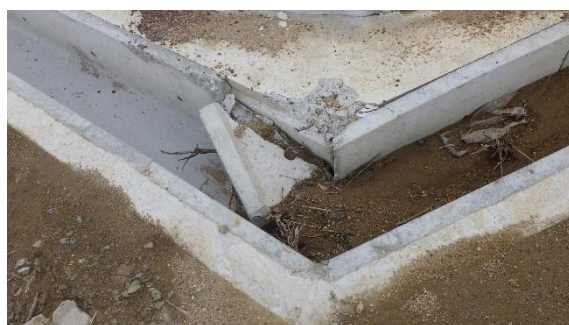
(写真1-3) 施設南東側の側溝の状況 (令和3年7月13日撮影) (南東側から撮影)
