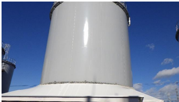
（写真3-2） J3雨水回収タンクの外観 （西側から撮影）
