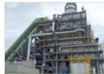
仮設焼却施設
