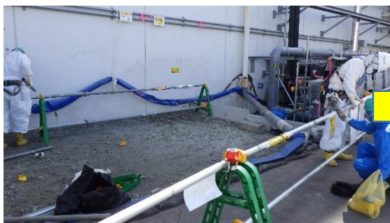
(写真5-1) 前回の陥没部の状況 (令和3年9月30日撮影)
