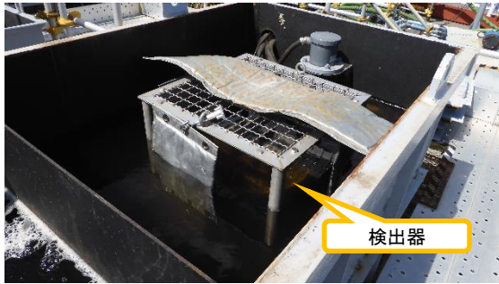
(写真 2 - 1) 既設の P S F モニタの検出器 (令和 2 年 4 月 10 日 撮影)
