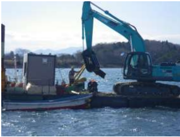
起重機船による漁場内に残存したがれき等の除去作業
