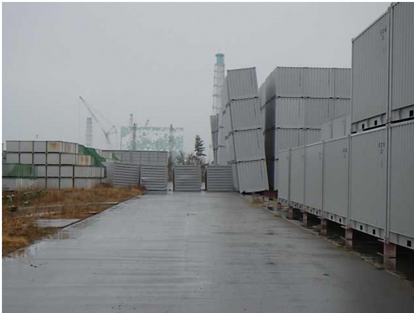
<エリアAA復旧前>
