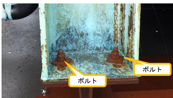
(写真1-4) タンク脚部と台座部分の状況
