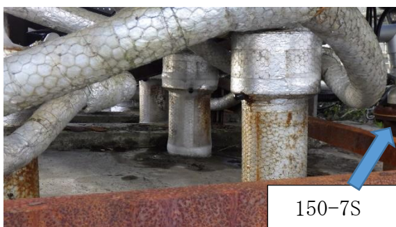
（写真5） ブライン供給管頂部の状況 （手前が測温管 150-7S に一番近いもの）
