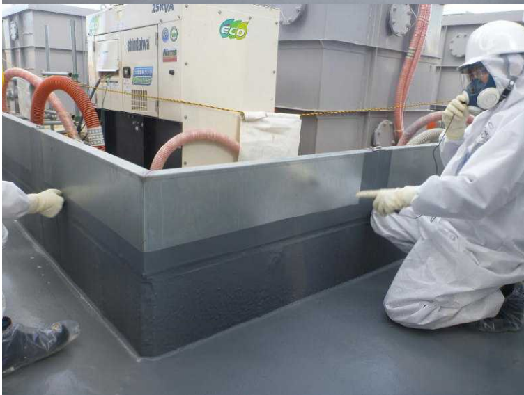
○現地確認 (G4タンクエリア) 鋼製の堰のつなぎ目の塗装の状況
