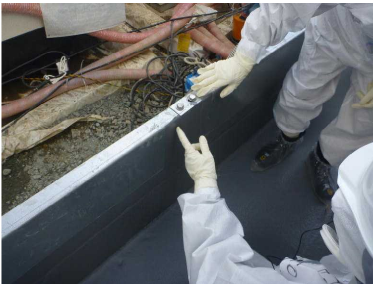
○現地確認 (G4タンクエリア) 鋼製の堰のつなぎ目の塗 装の状況
