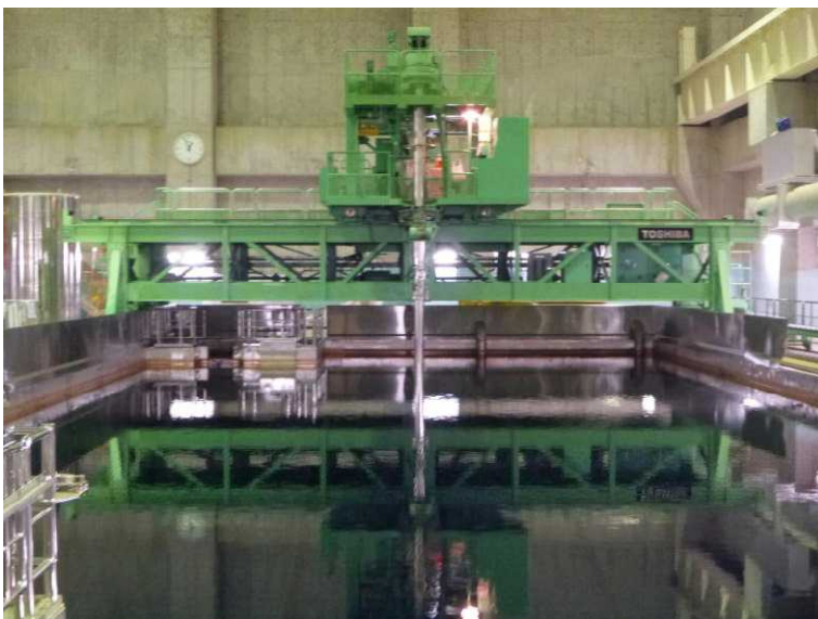
○共用プール建屋 燃料取替器
