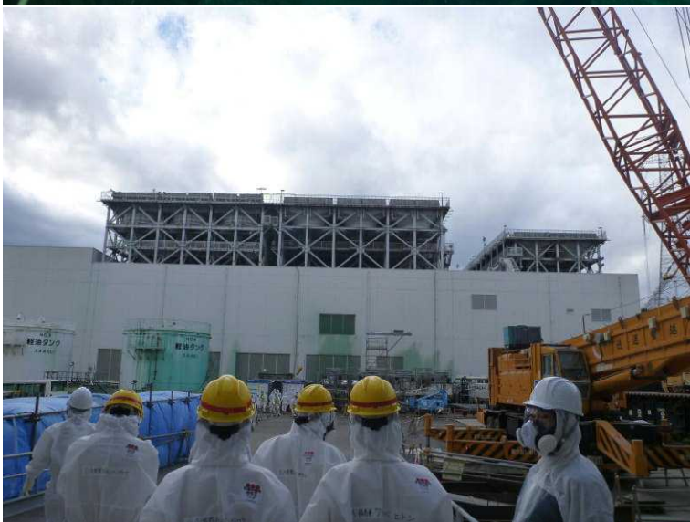
○共用プール建屋
