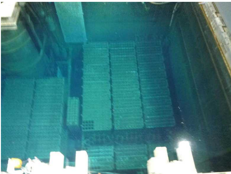
○使用済燃料プール上部 燃料ラック
