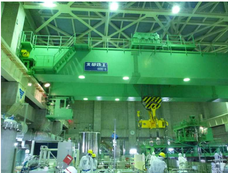
○共用プール建屋 天井クレーン
