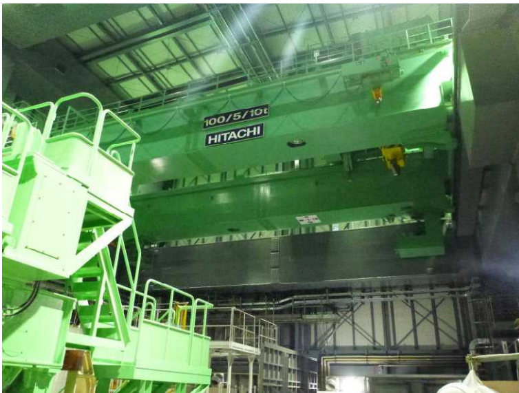
○現地確認 (4号機 天井クレーン)
