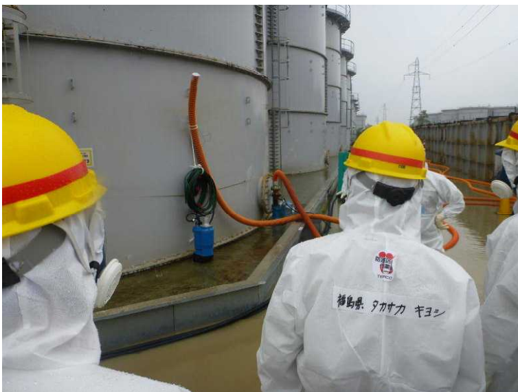
○H4エリア 堰内移送用大容量ポンプ
