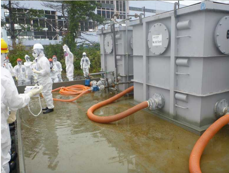
○現場確認 (4000 m 3 ノッチタンク 堰内)
