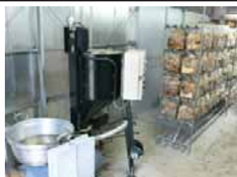
ペレットボイラー設置状況
