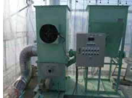
ペレットボイラー本体
