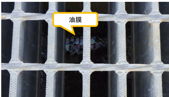
(写真2) 側溝内に流入した油の状況
