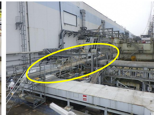
<設置後のフライングブリッジ>
