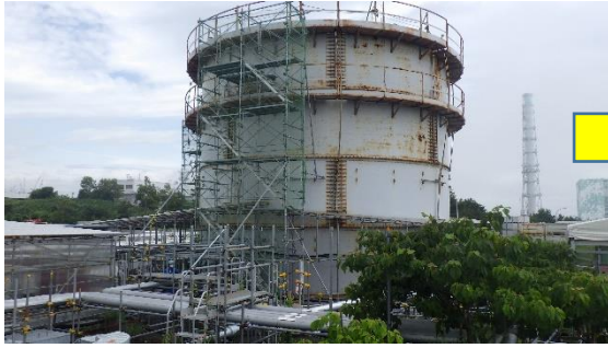
(写真4-1) 旧処理水バッファタンクの設置状況 (令和元年7月19日撮影)
