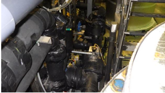
(写真 2 - 2) 閉止していたバルブの状況
