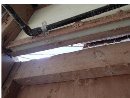
鶏舎ドアの隙間
