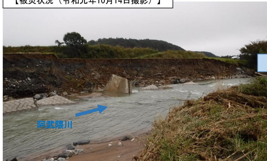
【被災状況（令和元年10月14日撮影）】
