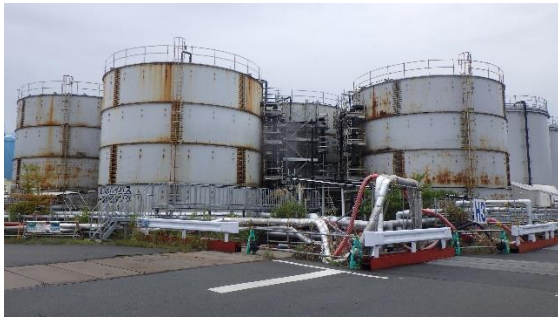
(写真1) 地下水バイパス一時貯留タンク エリアの外観 (北東側から撮影)
