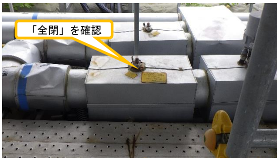
(写真2-1) 排水しないグループ2の排水弁 「全閉」であることを確認
