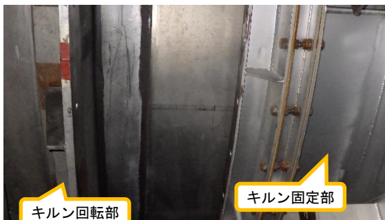
(写真1-2) 撤去工事後のロータリーキルンシール部(出口側) 構造は入口側と同じ
