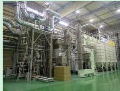
ライスセンター施設内設備
