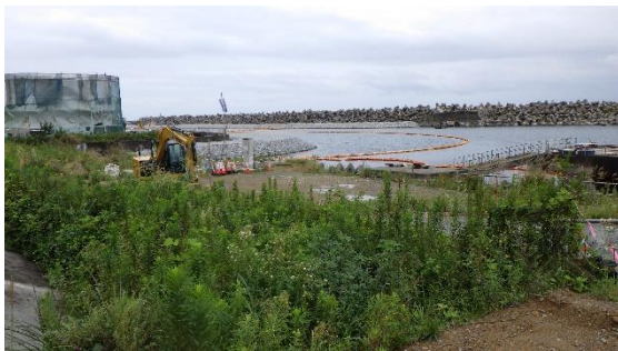
(写真 3) 下流側の到達立坑予定地の状況 (コンクリート殻は撤去されていた。)
