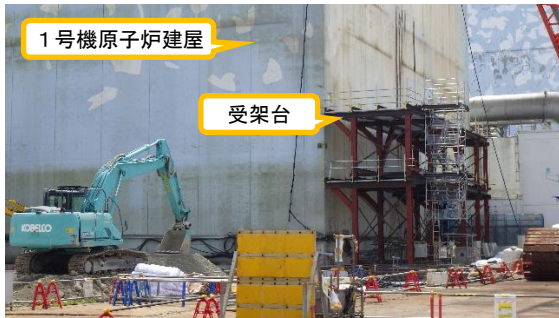
(写真1-1) アンカー削孔装置の受架台設置状況 (北西側から撮影)
