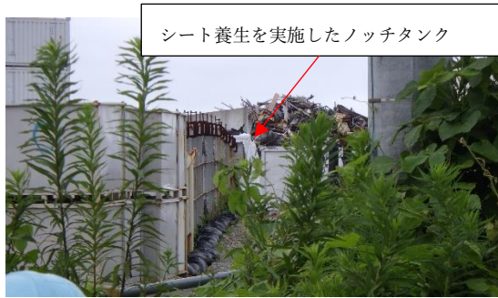
(写真1-3) シート養生を実施したノッチタンク
