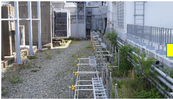
(写真 1 - 3) 配管敷設状況② (前回(5月12日)) (6号機原子炉建屋北東側を西側から撮影)
