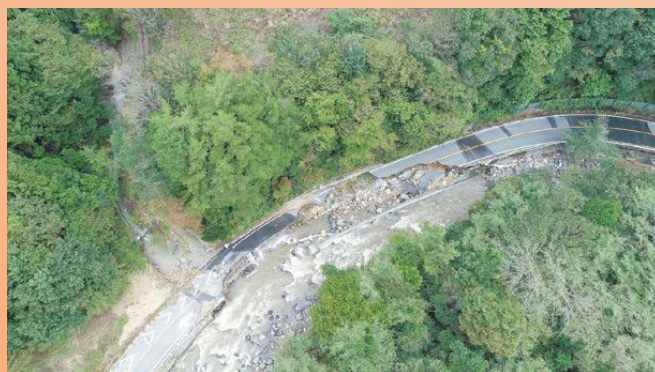
令和元年東日本台風による被害 国道115号（相馬市）
