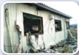
▲津波被害を受けた工場
