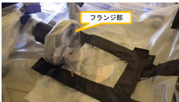
(写真1-2) 漏えいが発生した浄化ユニットC の吸着塔入口配管フランジ部の状況
