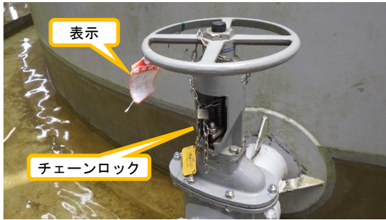
(写真3) チェーンロック取り付け等の状況 (表示は「操作禁止」の旨)
