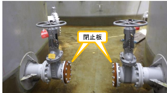
(写真2-2) 連結管取り外し後の状況 (令和3年5月24日撮影) (注) 写真2-1とは異なる箇所です。
